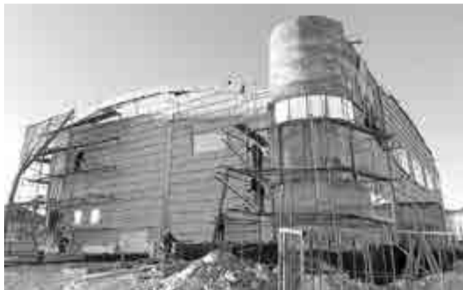
На строительстве бассейна в Оле успели до морозов закрыть наружные работы - сегодня можно заниматься внутренней отделкой.
